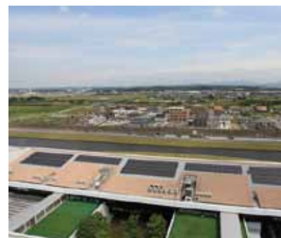
ポーラ化成工業 袋井工場の太陽光発電システム
