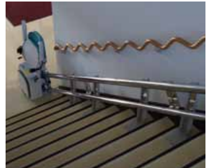
ポーラ化成工業 横浜研究所厚生棟昇降機
