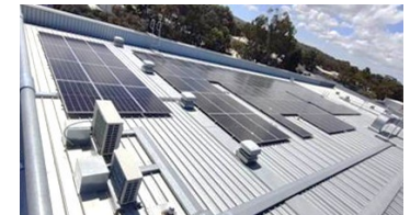
Jurlique アデレード工場の太陽光発電システム
