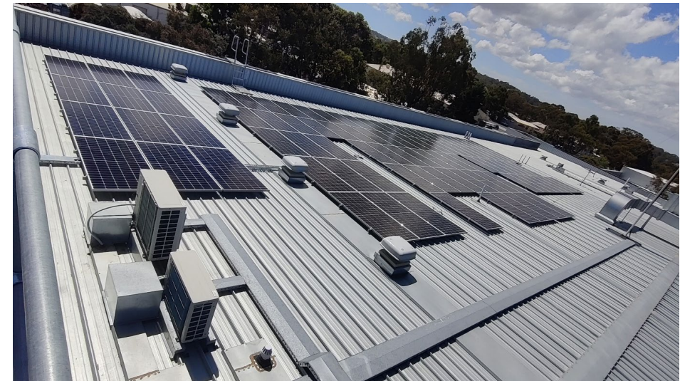
Jurlique アデレード工場の太陽光発電システム
